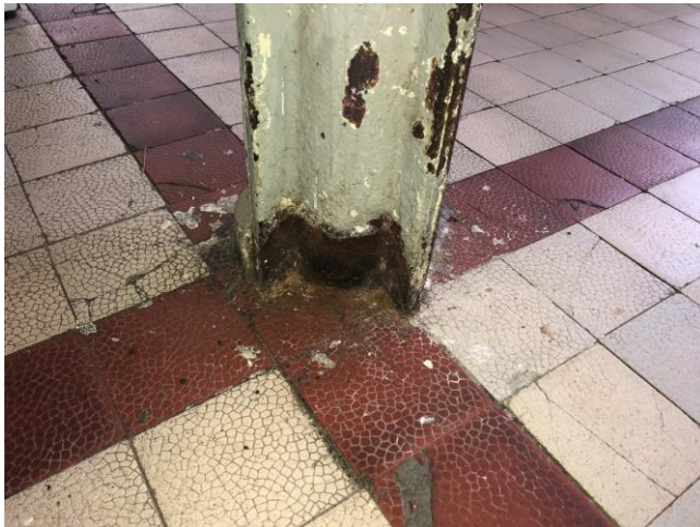
Foto Nr. 28 Lokāla korozija kolonnu balsta mezglā virs grīdas.
