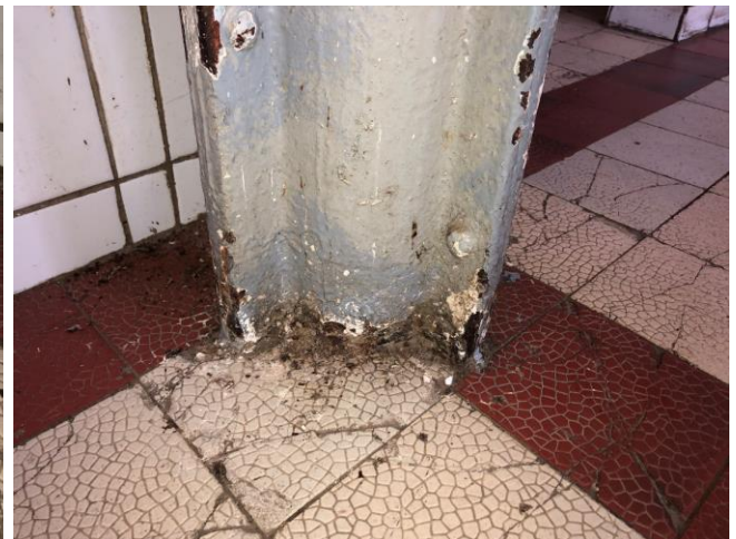
Foto Nr. 31 Lokāla korozija kolonnu balsta mezglā virs grīdas.
