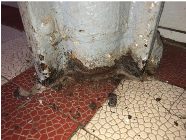
Foto Nr. 30 Lokāla korozija kolonnu balsta mezglā virs grīdas.
