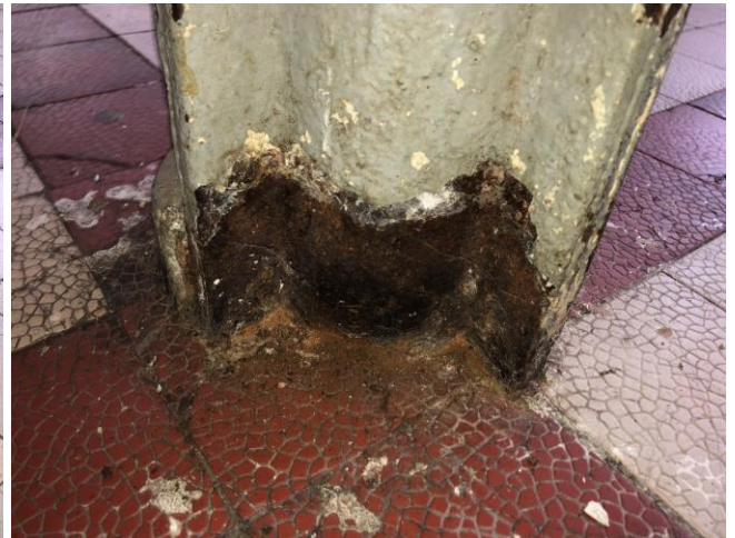
Foto Nr. 29 Lokāla korozija kolonnu balsta mezglā virs grīdas.
