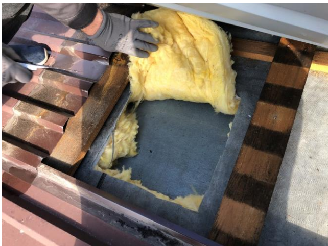
Foto Nr. 26 Siltinājums virs vecā jumta seguma.
