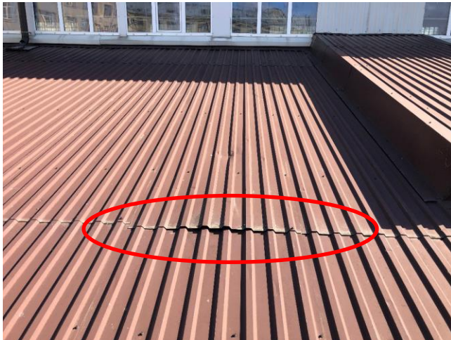
Foto Nr. 24 Lokālā vietā nenostiprināts seguma savienojums.
